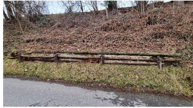
Abbildung 5: Zustand bergseitige Hangsicherung
